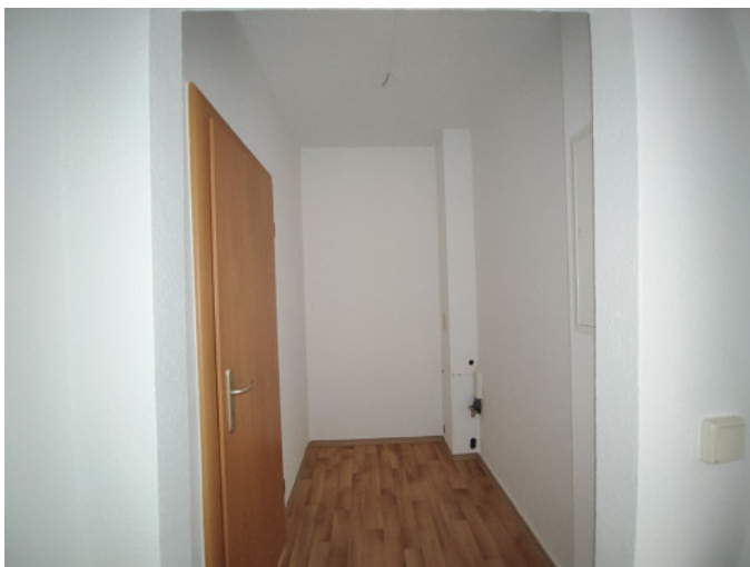
WM-Anschluss im Flur
